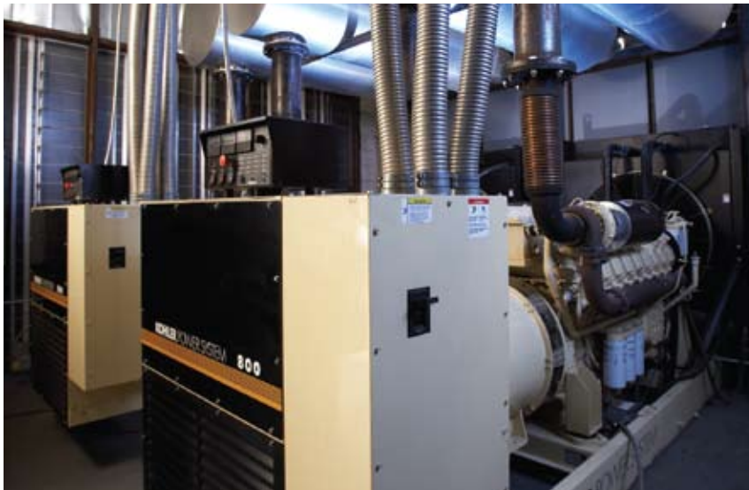
KOHLER 800 kW generator
