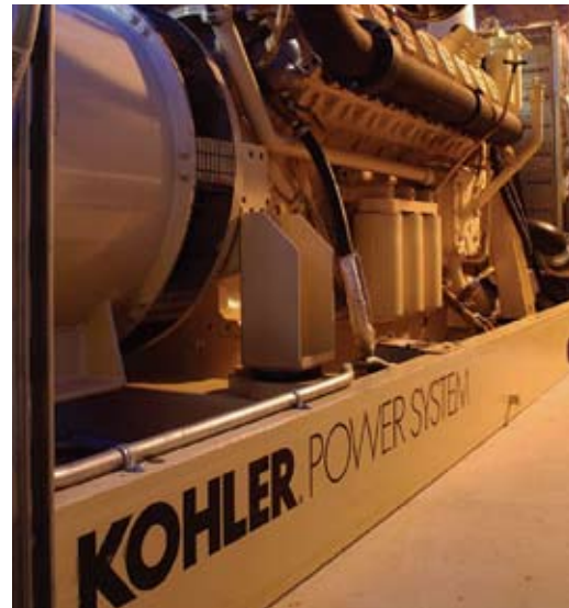
KOHLER 2000 kW generator
